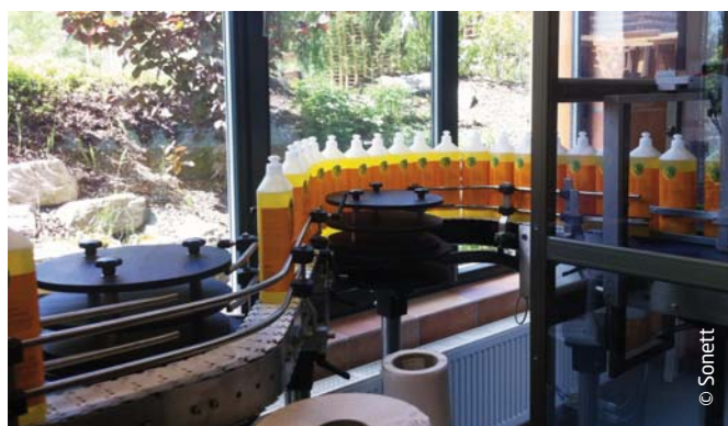
Die neue Abfüllanlage in der Flüssigproduktion
