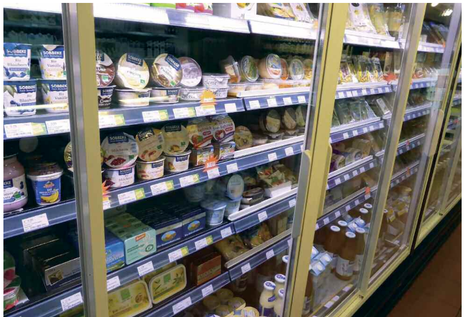
Steckerfertige Kälteanlagen lassen sich nicht auf alternative Kältemittel umrüsten. Da sie vergleichsweise wenig Kältemittel enthalten, ist ein Austausch aber auch nicht zwingend, so lange die Geräte gut laufen.
